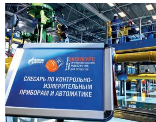
Слесари КИПиА устранили утечку газа на импульсной линии и неисправность электропневматического узла управления
