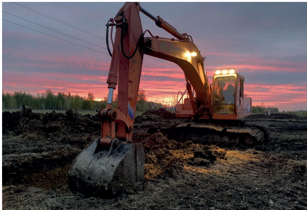
Специалисты Омского ЛПУМГ и УАВР устранили дефекты на 24-километровом участке МГ СРТО – Омск
