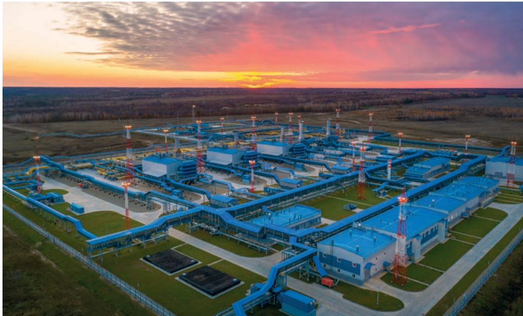
Компрессорная станция «Атаманская»
