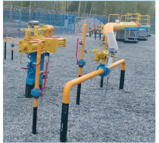
Камера приема диагностических устройств на МГ Новосибирск – Барнаул
