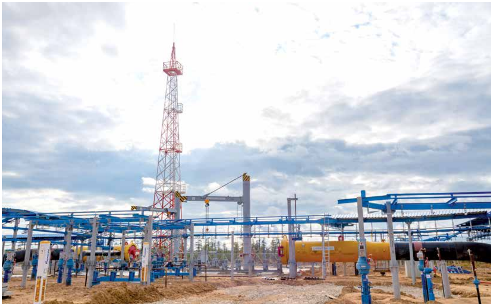
Узел подключения КС-4 «Нимырская» к магистральному газопроводу
