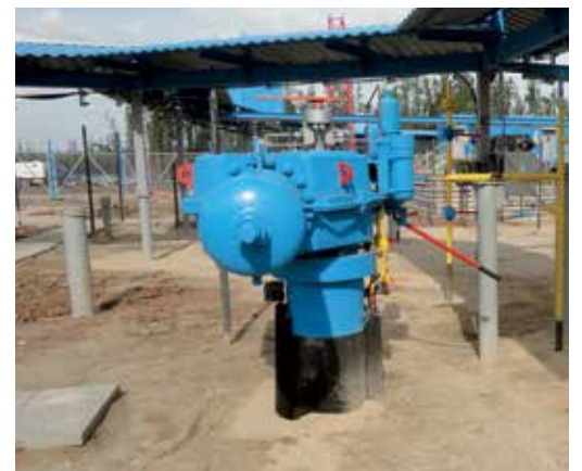
Запорная арматура на втором километре магистрального газопровода «Сила Сибири», где расположен узел запуска очистных устройств
