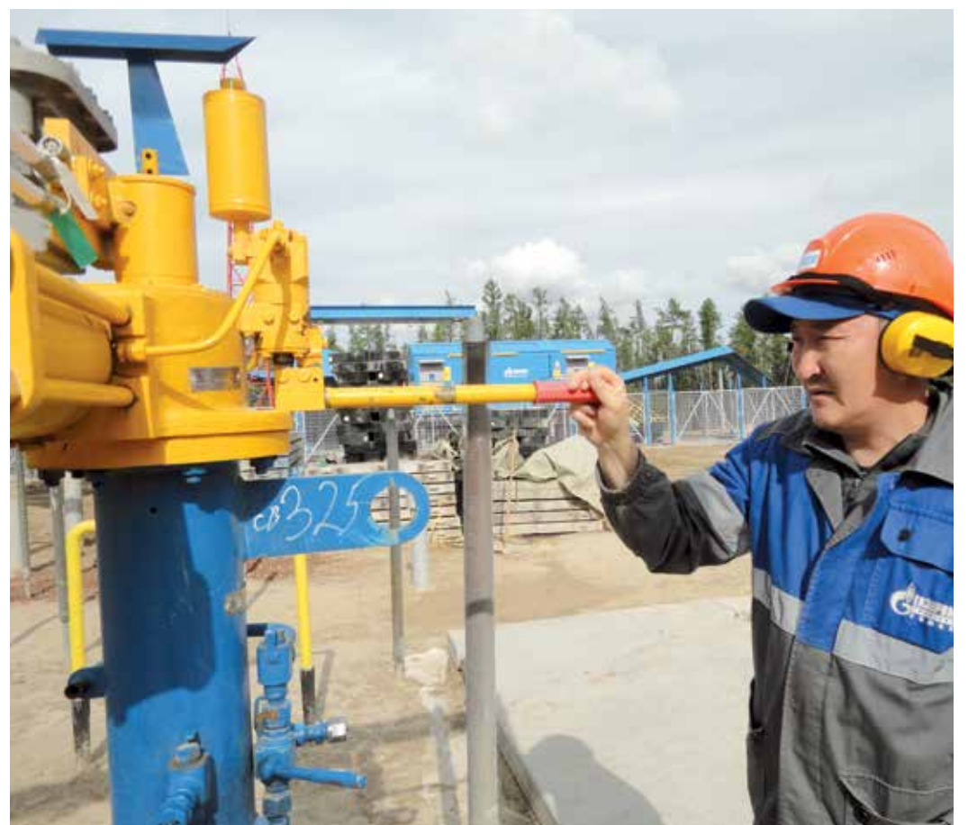
Линейный трубопроводчик Ленского ЛПУМГ Гавриил Пахомов открывает один из первых охранных кранов на пути газа в Китай
