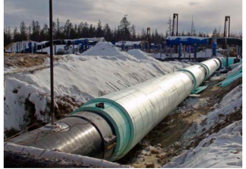
Через эту трубу газ поступит на компрессорную станцию КС-2
