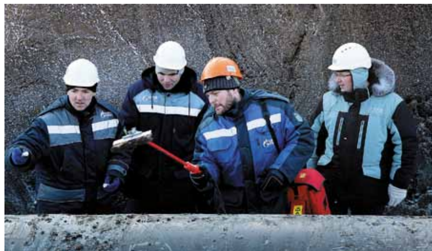
Специалисты УАВР и Чажемтовской промплощадки определяют места дефектов изоляции МГ Парабель – Кузбасс
