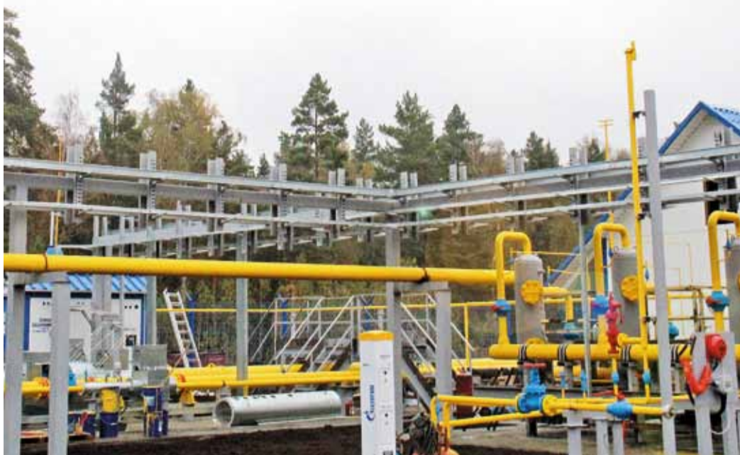
ГРС-3 Алтайского ЛПУМГ: во время проведения ремонтных работ подача газа потребителям не прекращалась
