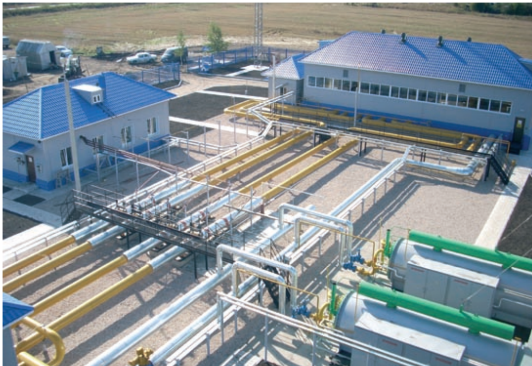
Телемеханизация Омского ЛПУ позволит автоматизировать стратегически важные объекты газотранспортной системы
