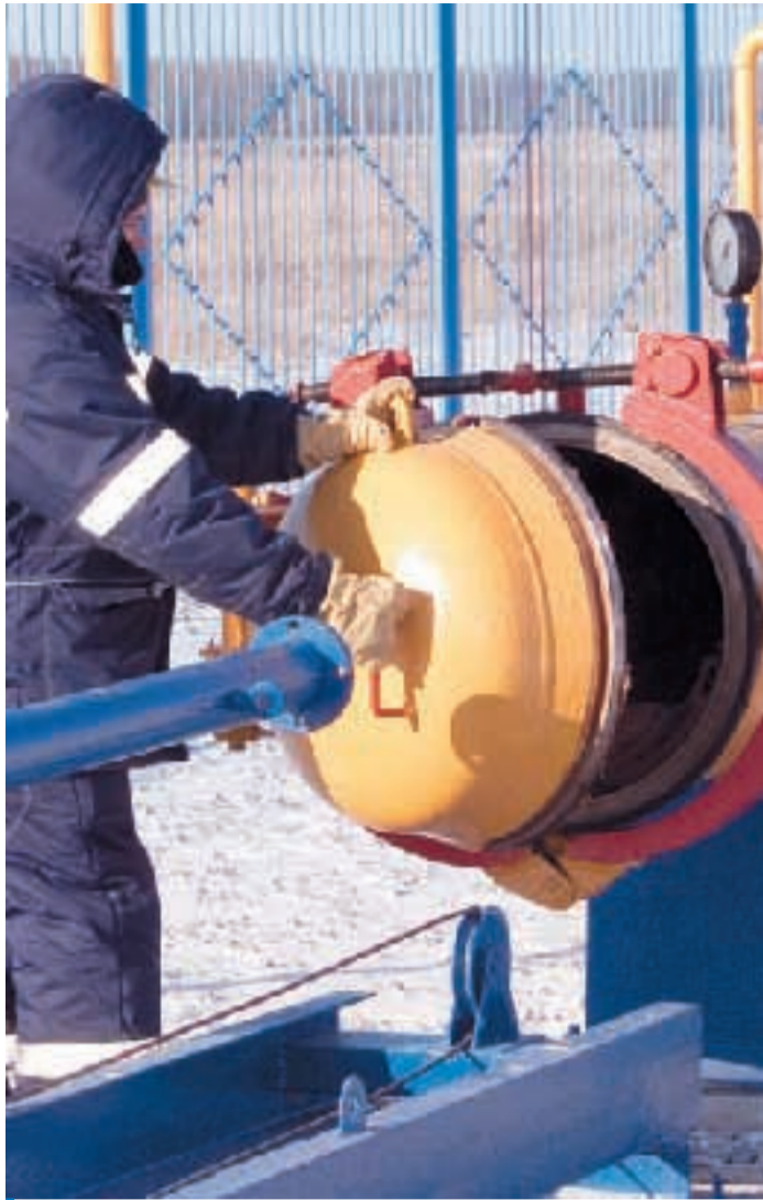
Камера приёма дефектоскопа на магистральном газопроводе «Комсомольск-на-Амуре – Хабаровск»
