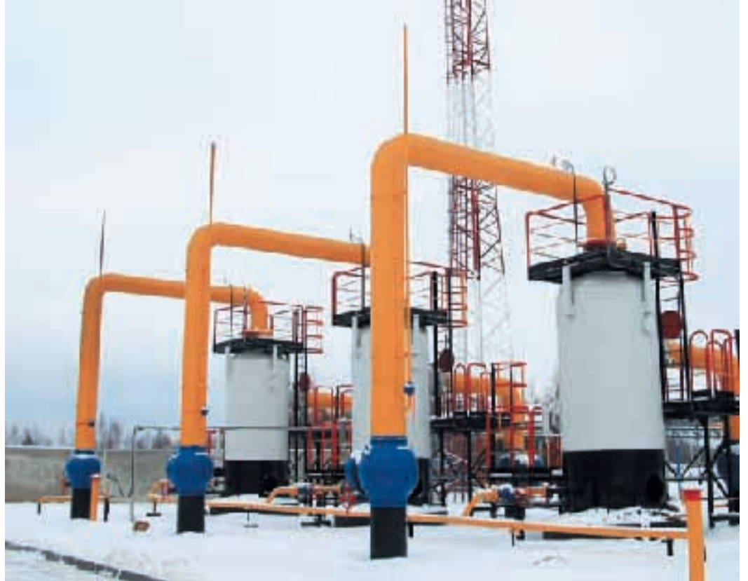
Оборудование компрессорной станции «Володино» соответствует мировым стандартам в области транспортировки газа
