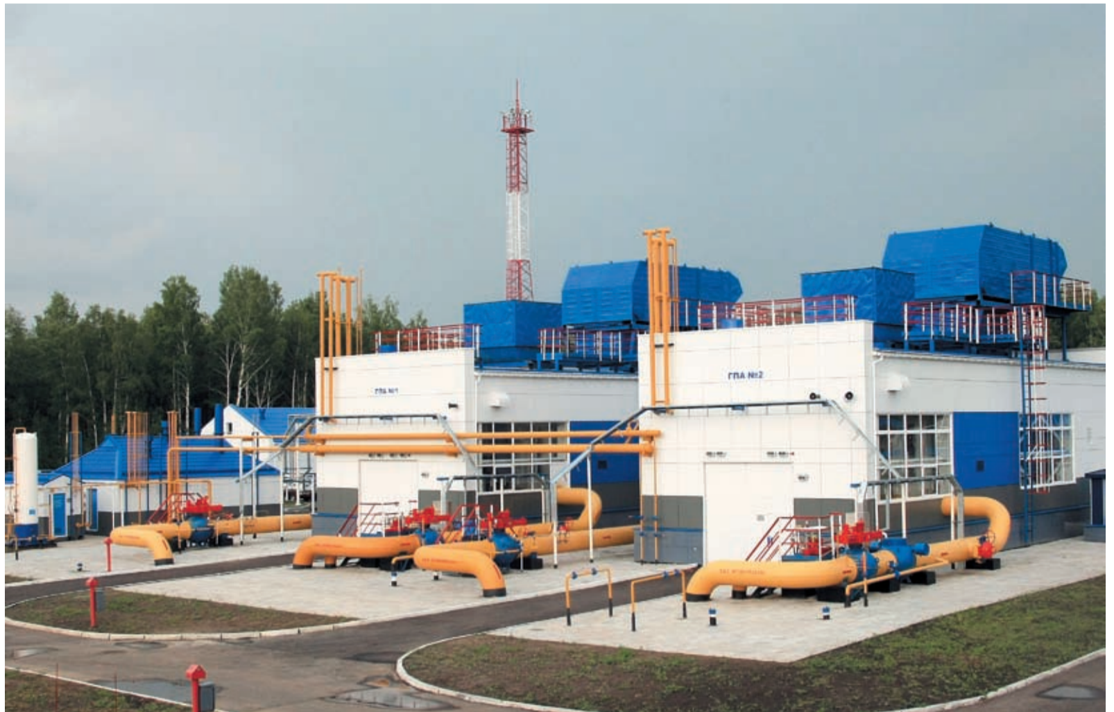
Омская компрессорная станция настолько совершенна в своем исполнении, что похожа на космический объект. Она связала газотранспортную систему предприятия «Газпром трансгаз Томск» с Единой системой газоснабжения России
