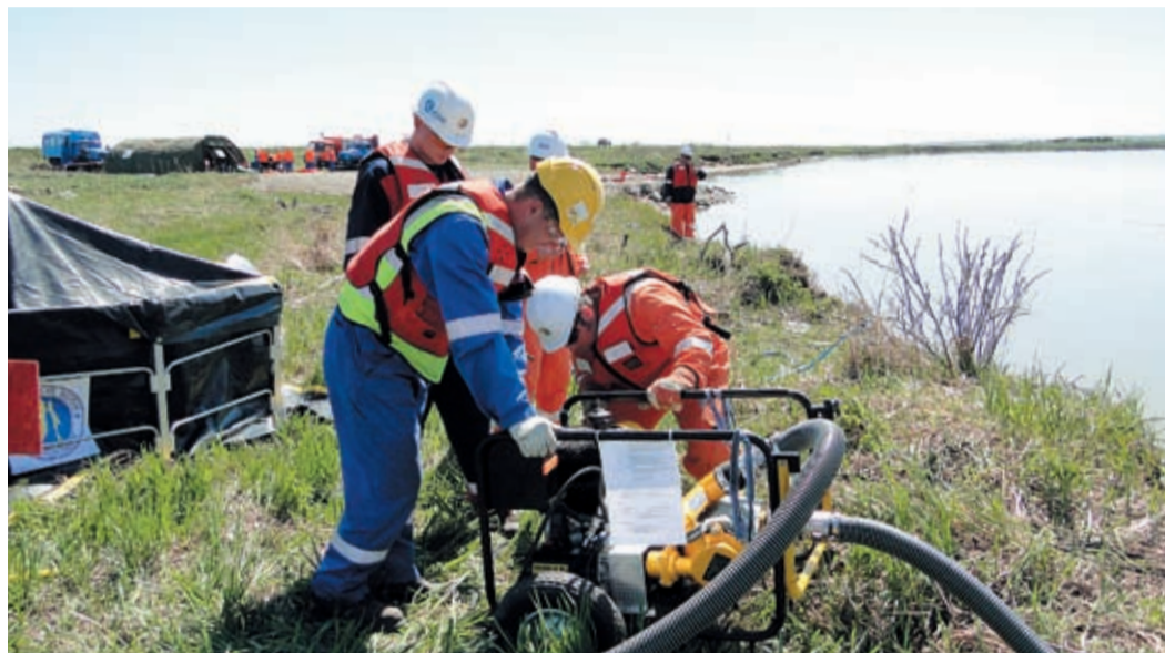
В Сахалинском ЛПУ МТ регулярно проводятся учения по устранению аварийных разливов нефти. Все действия аварийных бригад доводятся до автоматизма (ПП «Советское»)
